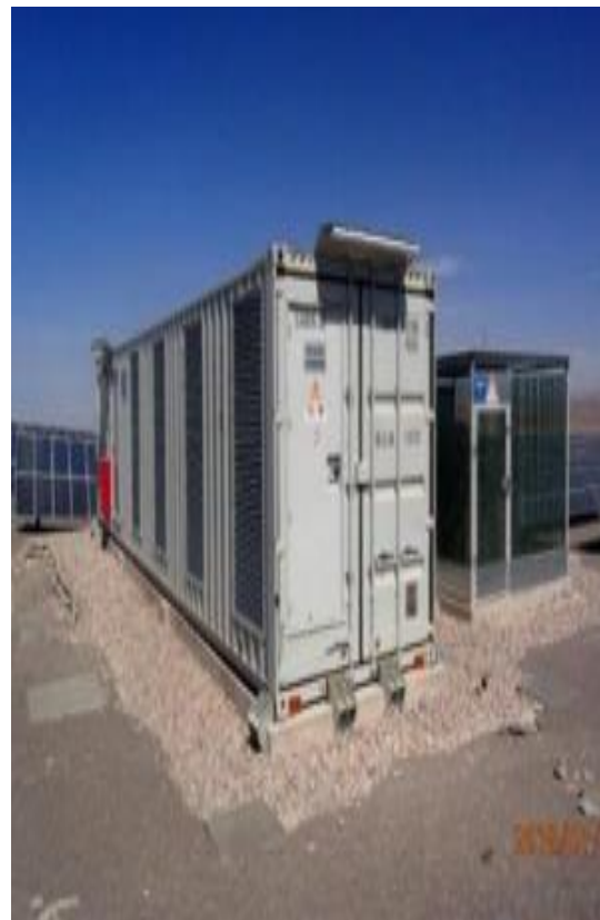
Figura N°8 CENTRO DE TRANSFORMACIÓN
