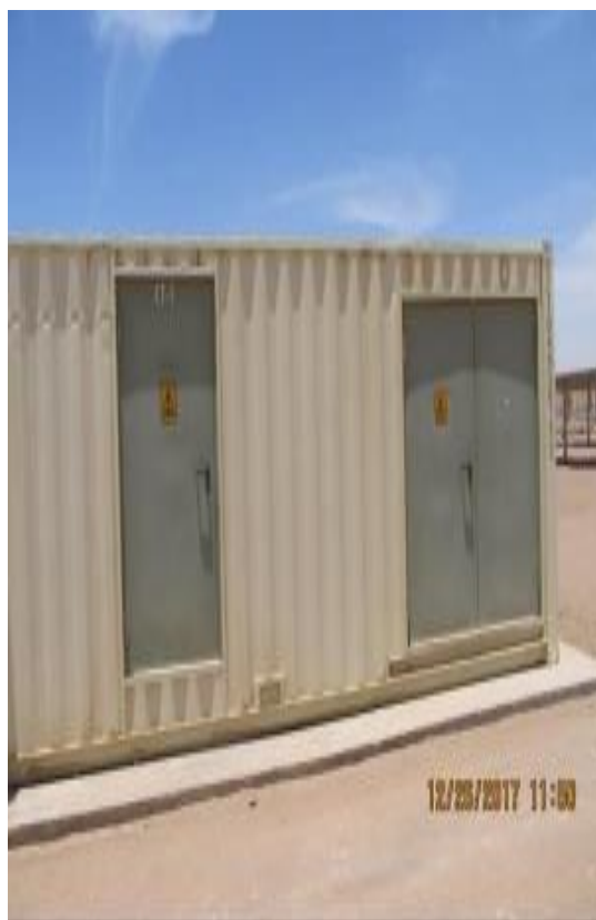
Figura N°18 CENTRO DE TRANSFORMACIÓN
