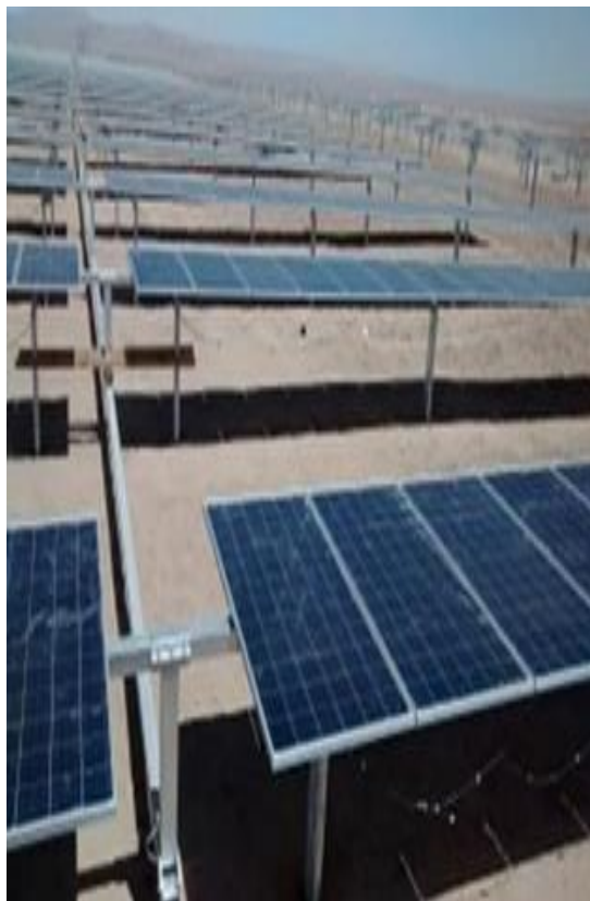
Figura N°12 CENTRAL SOLAR MOQUEGUA FV
