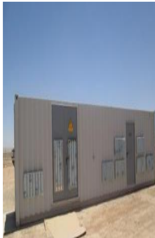
Figura N°13 CENTRO DE TRANSFORMACIÓN
