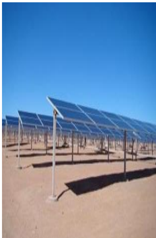
Figura N°17 CENTRAL SOLAR MOQUEGUA FV
